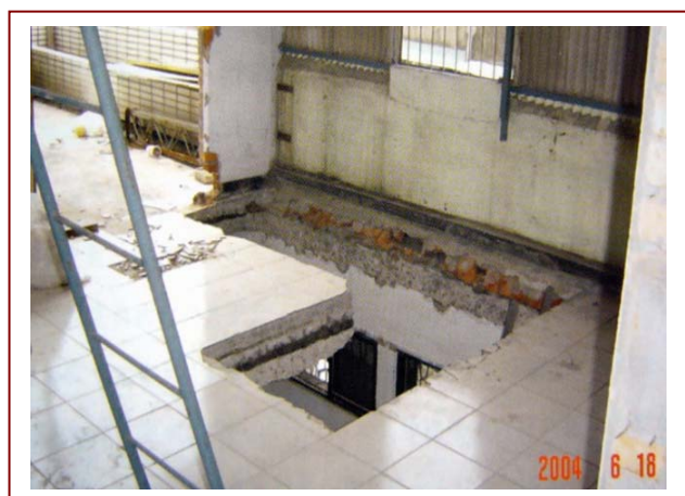
▲ 拆除樓地板涉及主要構造之變更，已逾越室內裝修管理範疇
