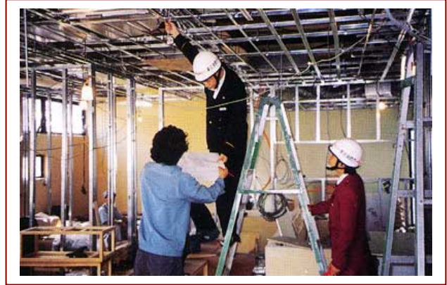
▲ 室內裝修施工期間，主管機關得隨時派員抽查並督導室內裝修有關業務
