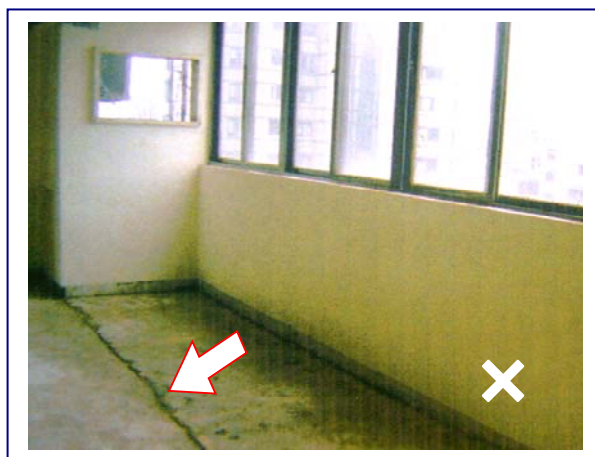
▲ 擅自拆除陽台外牆，導致陽台根部開裂之案例
