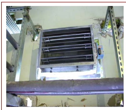
▲ 貫穿防火區劃牆壁之風管，其管內應設置防火閘門或閘板。
