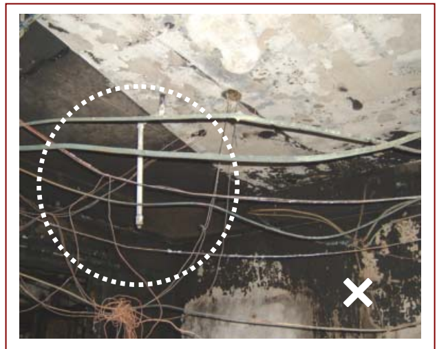
▲ 本市敦化南路某大樓第 16 樓室內裝修施工過程擅自剪斷火警警報系統並封閉灑水頭致災案例
