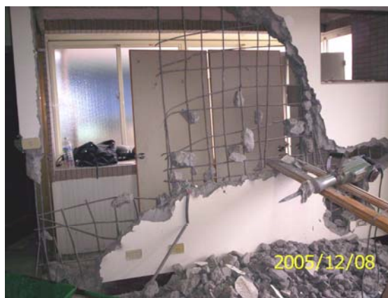
▲ 室內裝修涉及分間牆變更者，結構安全應經開業建築師簽證負責。
