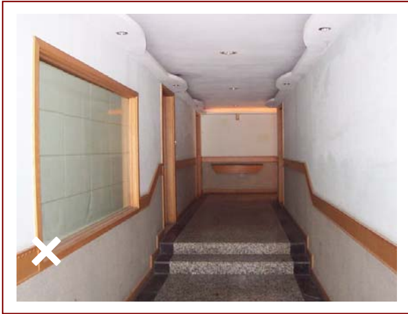
▲ 走廊不得設置臺階，其地坪如有高差應以斜坡處理，但坡度不得超過十分之一。
