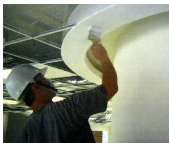
▲一般居室空間以木板裝修部分，得採用經檢驗符合規定的防火塗料刷塗改善。
