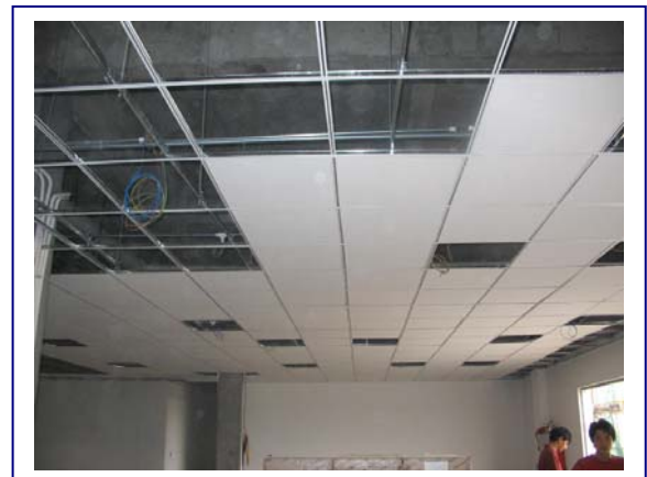
▲ 具有檢修功能的輕鋼架天花板
