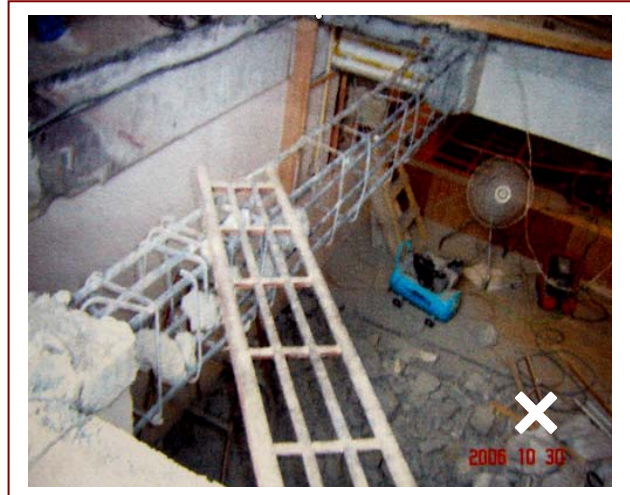
▲ 委託未經登記許可的非法業者進行室內裝修施工，肇致破壞主要構造案例
