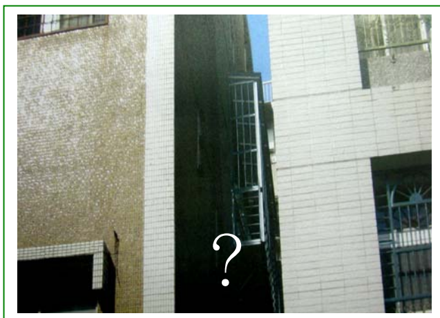
▲ 建築物非臨接道路側之外牆面開窗，依法應自境界限退縮 1 公尺以上。
